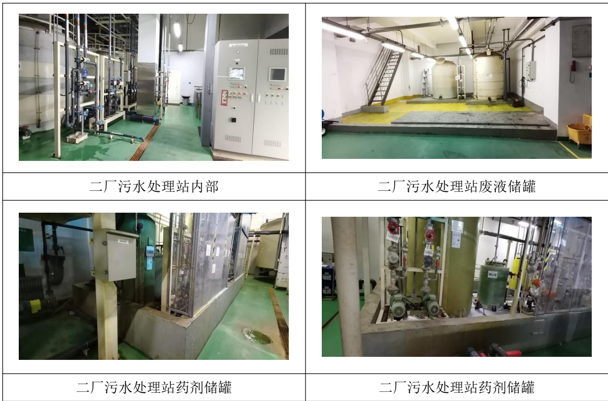
图 5-2 二厂污水处理站现状
