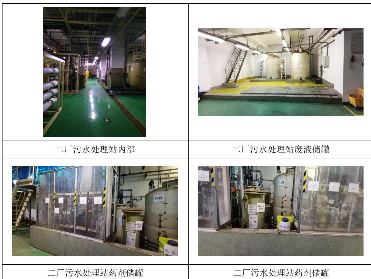
图 5-1 二厂污水处理站现状
