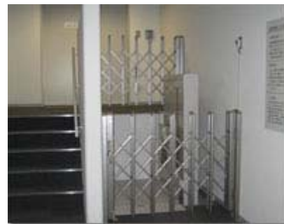
北伊丹事業所、車椅子専用のエレベーター
