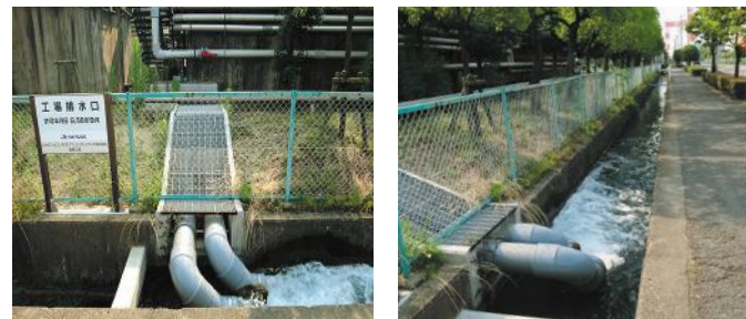
見える化した工場排水配管の状況
